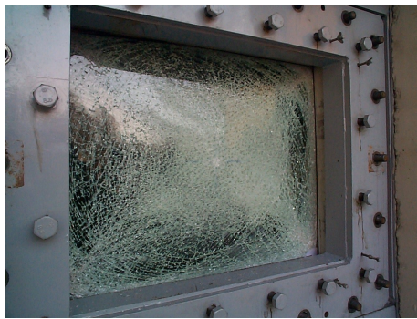
Bild 5: Glasbruch durch Explosionsbelastung
